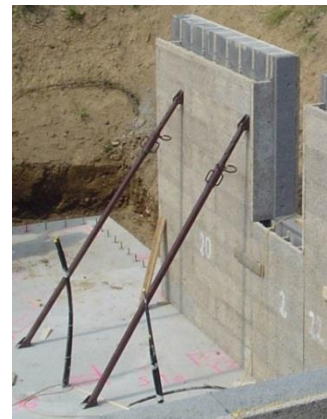
Gesicherte Wand mit 2 Stehern
